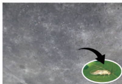
写真7 大型店舗のカビで真黒な天井と無数に広がるチャタテムシの状況
