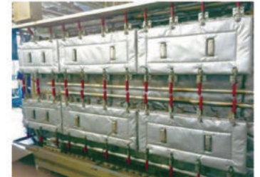
写真4 焼成炉(内燃温度900℃度前後)への「新断熱ジャケット・えこきーぱー」の取付例
