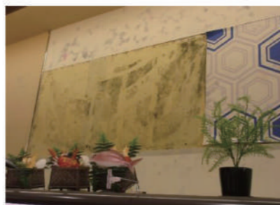
写真8 バックヤードに冷蔵庫があり、断熱不足でカビが発生した状況。ここに断熱の強化を行い、内装仕上げ工事+防カビ施工をする。
