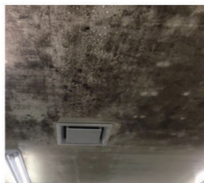
写真6 天井面が結露して、カビが発生した状況の一例
