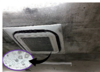
写真5 エアコン噴出口がカビた依頼者が誤った施工をした結果の一例
