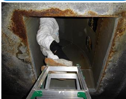
AHU内部 RAダクト
