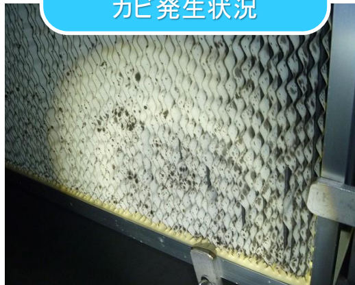
交換前フィルター カビ発生状況
