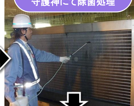
⑤熱交換器 カビ守護神にて防カビ処理
