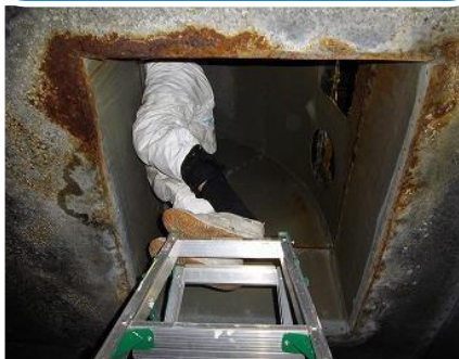
AHU内部 RAダクト
