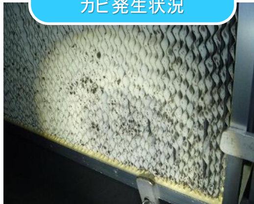
交換前フィルター カビ発生状況
