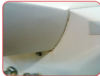
作業前の状態（洗面台のふちにカビが発生していました）
