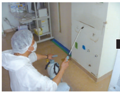
噴霧器を使い【守護神】で除菌しながら、カビを清掃して取り除き、【カビ守護神】で防カビ処理
